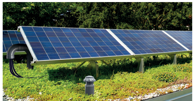
Kombination von Gründach und aufgeständerter PV-Anlage.
